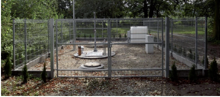
Przepompownia ścieków w Romnowie
